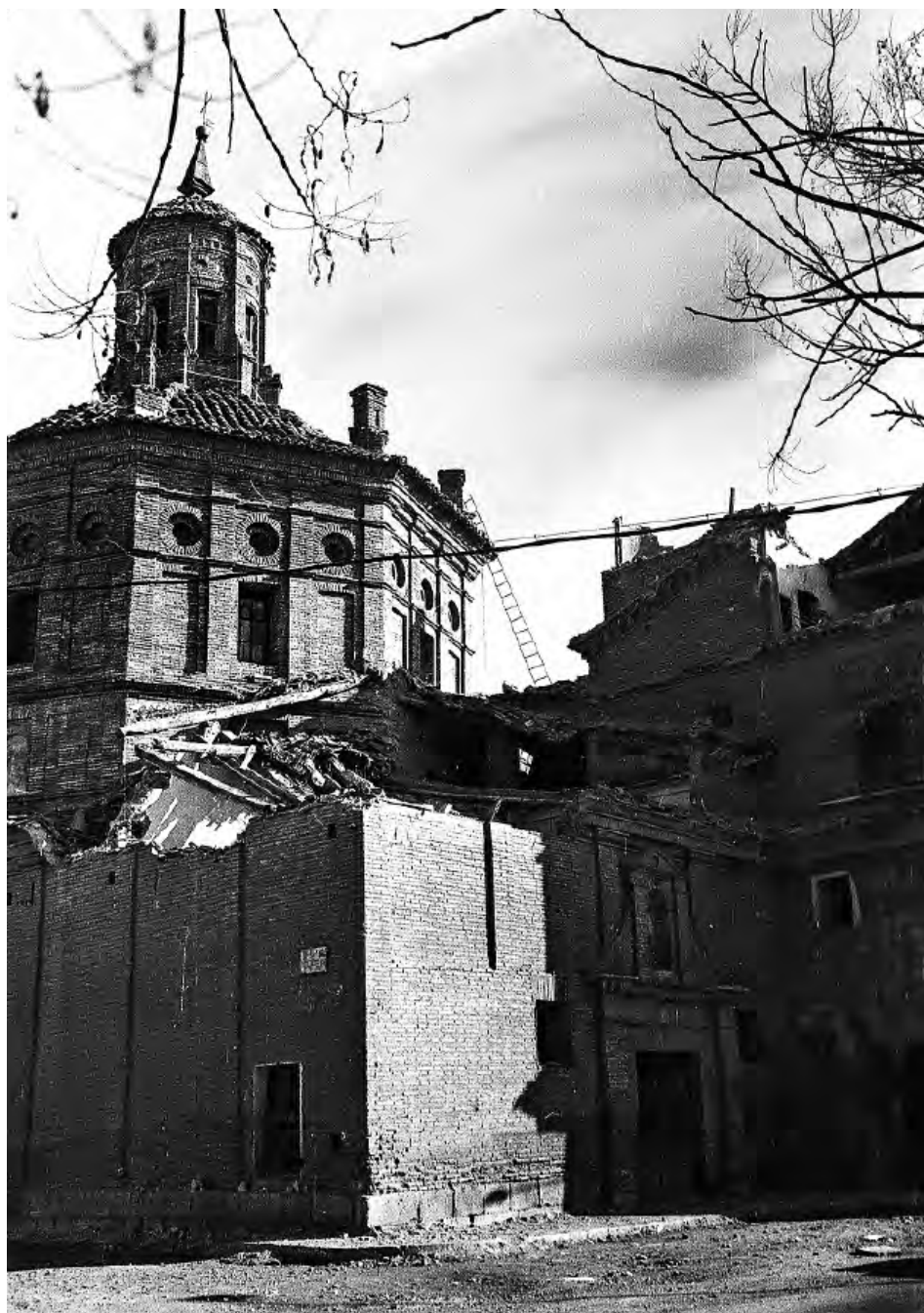
Fig. 16. Exterior de la iglesia en proceso de demolición. Calatayud, convento de San José. Francisco de Aguirre, 1622-1625. Foto Carlos Moncín.
