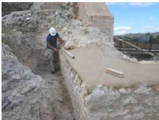
Sancamiento de la coronación durante el trabajo.
